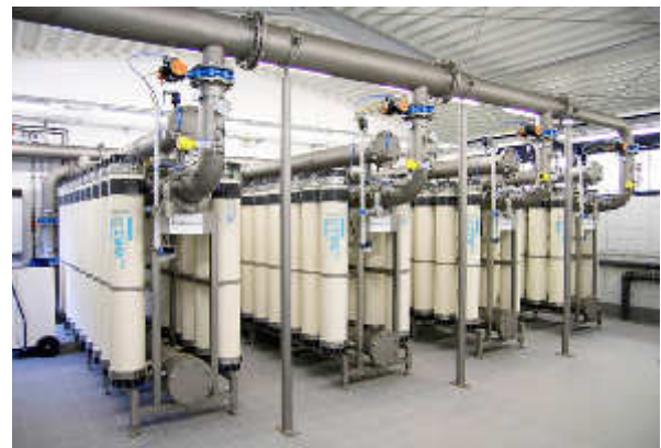
Ultrafiltration im Wasserwerk Grundmühle
